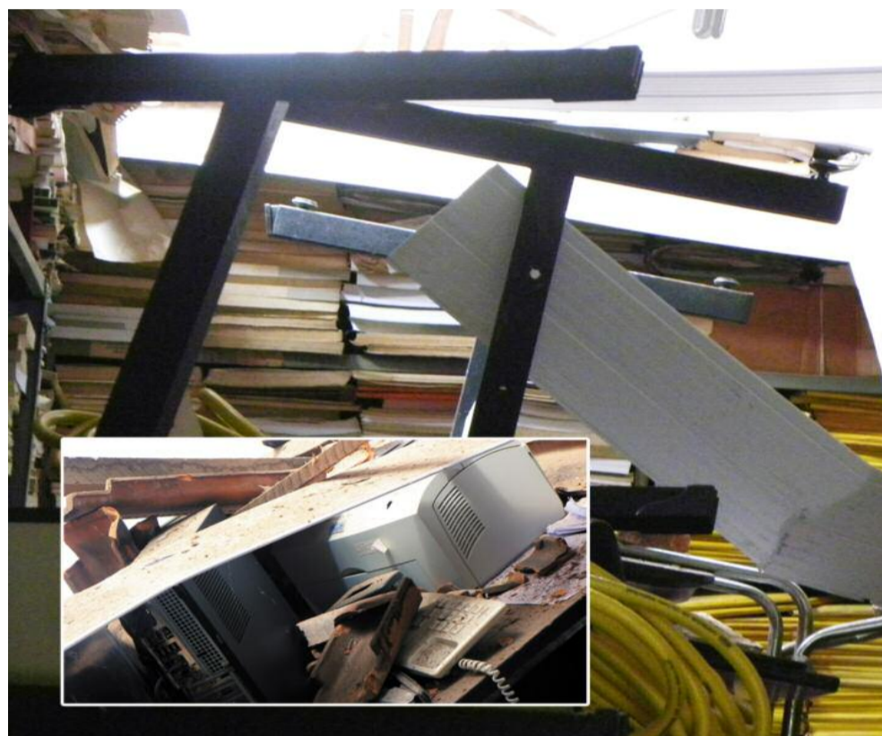
Com a queda do teto, processos e computadores só não sofreram maiores danos porque não choveu
